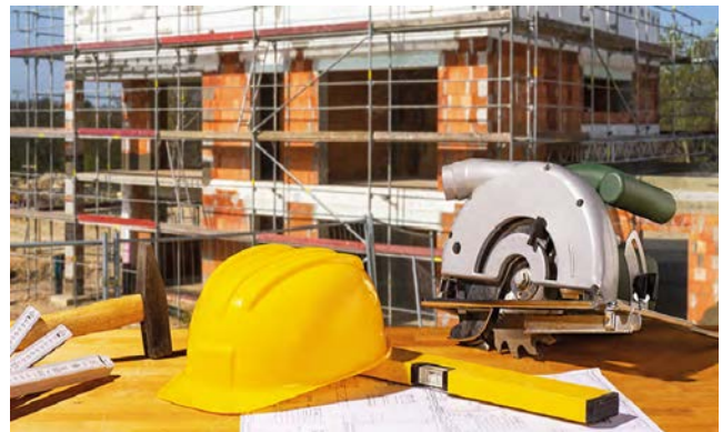
Oft liegen Baustoffe und Werkzeuge unbewacht auf der Baustelle und ermöglichen leicht einen Diebstahl
