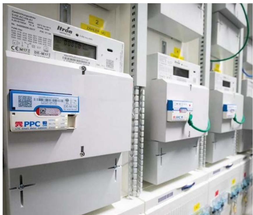
Ein Kommunikationsmodul mit „Gateway“ macht Stromzähler zum intelligenten Messsystem und Kommunikationsgerät, das Verbrauchsdaten verschlüsselt an vertraglich gebundene Stromlieferanten und Netzbetreiber übermittelt.
