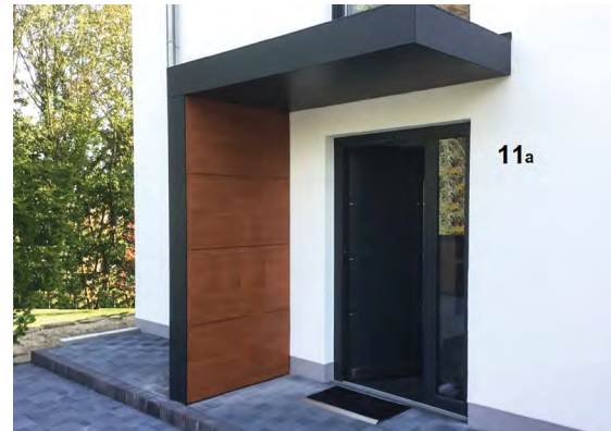
Wenn Eigentümer auf ihre Kosten gesonderte Maßnahmen am Gemeinschaftseigentum gestalten, wie hier beim Wetterschutz einer Haustür, sollten sie vorab unbedingt die Zustimmung der Eigentümergemeinschaft einholen.
