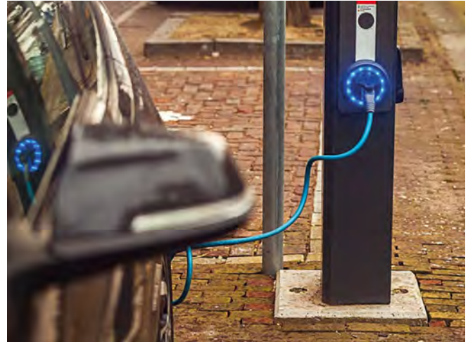
Forschungsaktivitäten des Bundes (BMW) umfassen bei der Elektromobilität unter anderem die Batterieforschung, Standardisierung, Netzintegration, Abrechnung von Strom an Ladesäulen sowie Infrastruktur.
